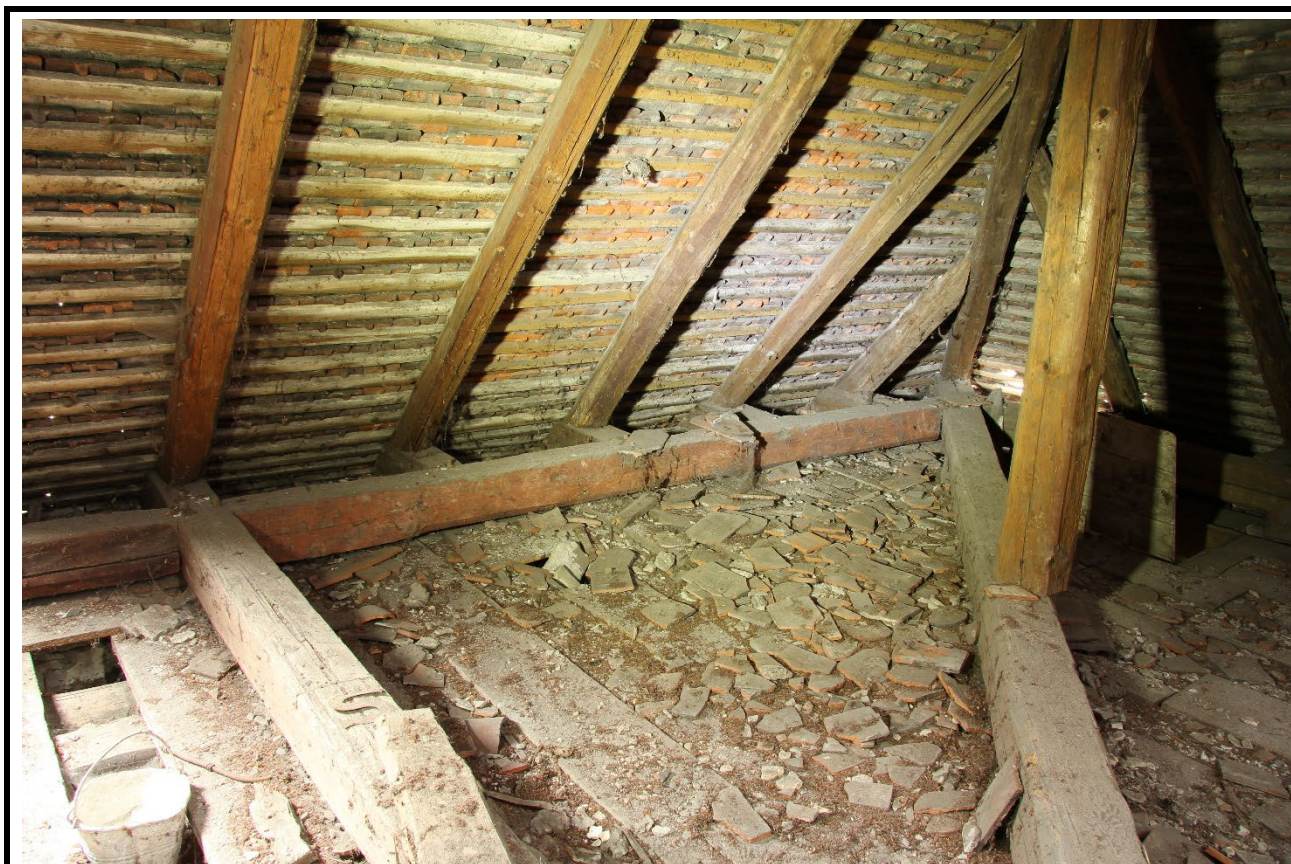
Severní výměna západní strany krovu nad lodí v pohledu od jihovýchodu. Foto: Jaroslav Skopec 2018.
