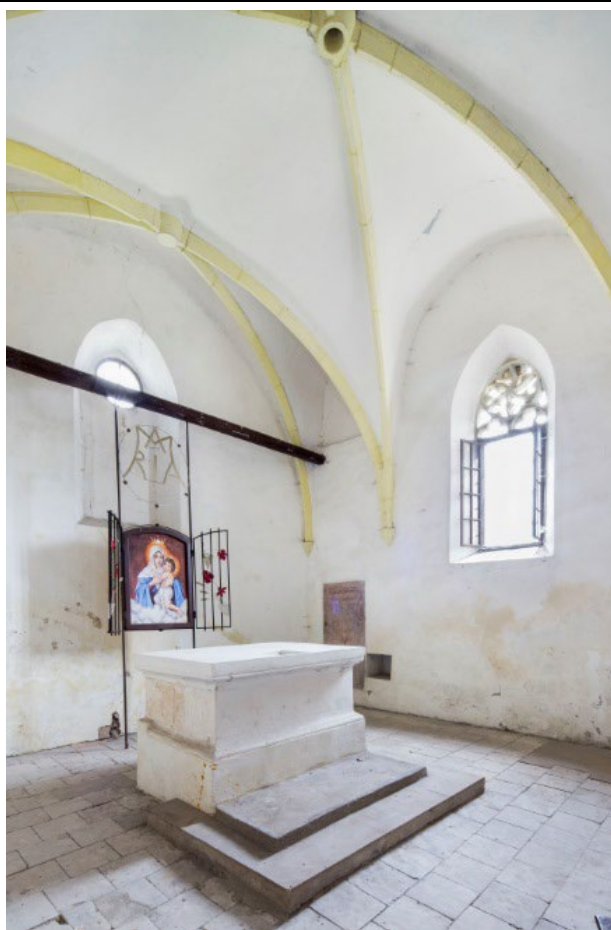
Interiér presbytáře v pohledu od severozápadu. V popředí menze hlavního oltáře. Foto: Marta Pavlíková 2018.
