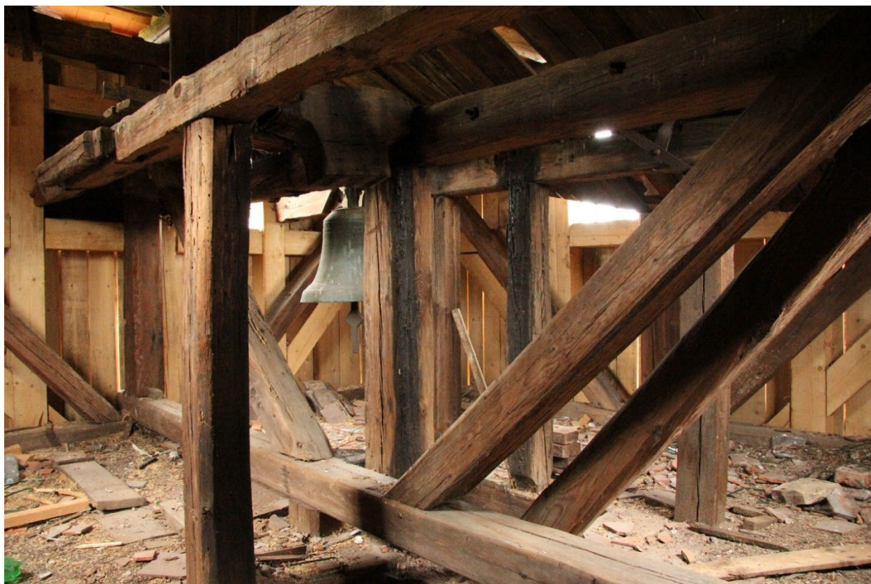
Pohled od severozápadu do interiéru 2. patra věže se zvonovou stolicí. Foto: Jaroslav Skopec 2018.
